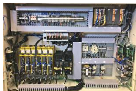
自動制御装置
